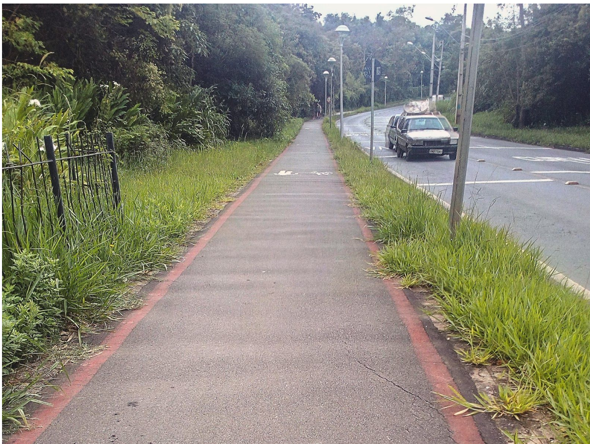
Figura 1 — No passeio compartilhado da Av. Fredolin Wolf, construída em 2011, o asfalto ondulado é constante, ocorrendo em trecho por mais de 10 quilômetros Foto: Henrique Jakobi Moreira (2019)
